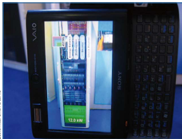
Einsatz einer AR-Anwendung im Bereich Monitoring und Service. Die lokalen Parameter (Temperatur, Energieverbrauch, Fehlermeldungen) des Racks werden dem Kamerabild des UMPC überlagert.
